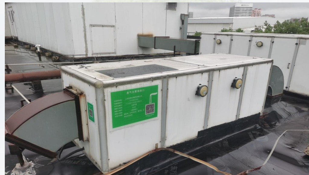
该生物制药公司废气排放口未安装自动监测设备
